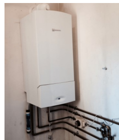
Chaudière à gaz pour l'eau chaude et le chauffage.
